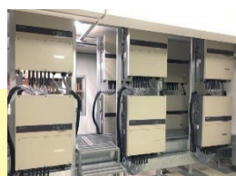
2. เครื่องแปลงกระแสไฟฟ้า
